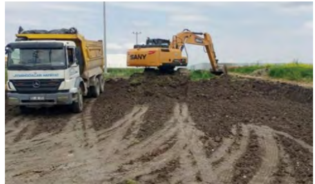
Yeni Açılacak Yollarda Hafriyat Yapılması, Dolgu Malzemenin Temini ve Serilmesi Yapım İşİ
